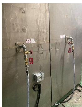
破碎機センサーと散水栓
