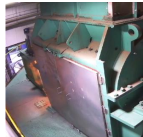
(破碎機発火時の状況)
