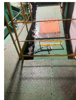
搬送コンベア散水栓
